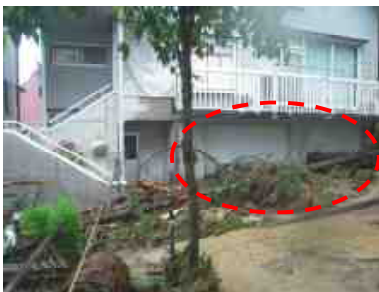
【シャッターを破り土砂が流入】
