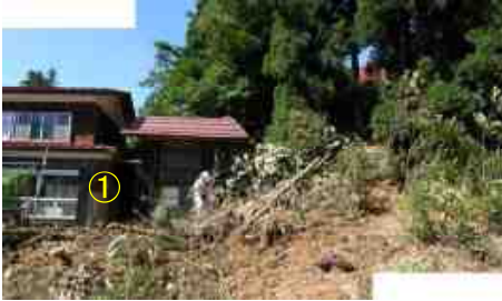
【崩壊土砂により人家一部損壊】
