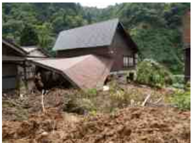
【崩積土により全壊した倉庫】
