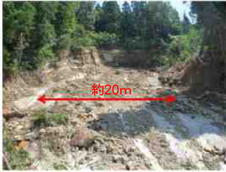
【崩壊発生箇所の状況】
