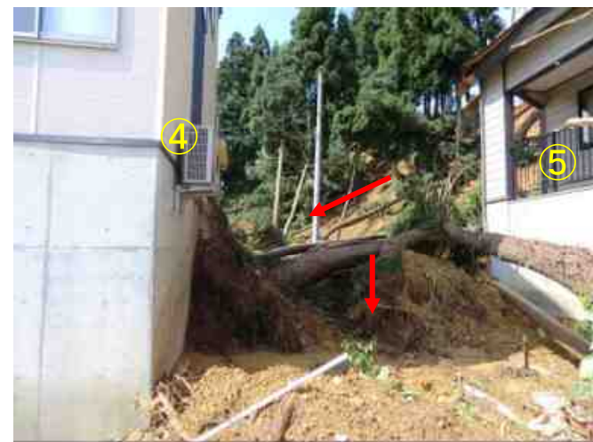
【④家屋と⑤家屋の間に流入した土砂】
