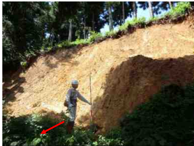
【滑落崖の状況】 高さ約7~8m
